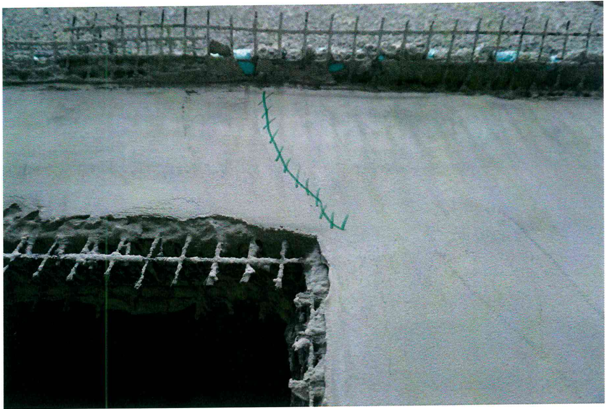
Рисунок 27 - Состояние образца после испытаний
